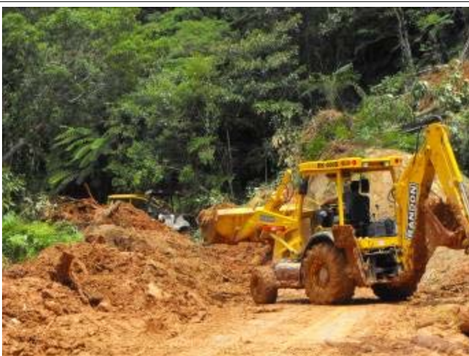
Foto 9. Trabalhos de desobstrução da estrada que liga Laranjeiras ao Patrimônio após deslizamento.
